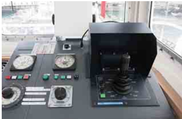
図 41 遠隔操縦装置
