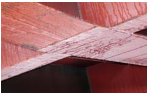
写真6 ハッチカバー裏に汗濡れが発生 Fig.6 Sweat formation on the underside of a hatch cover.
