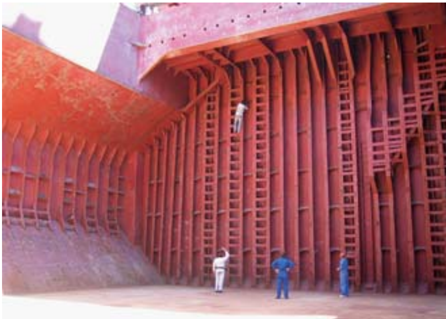
写真 10 穀物積載前に艙内を点検する様子。構造部材表面に多くの錆が浮いていたため積載拒否された。
