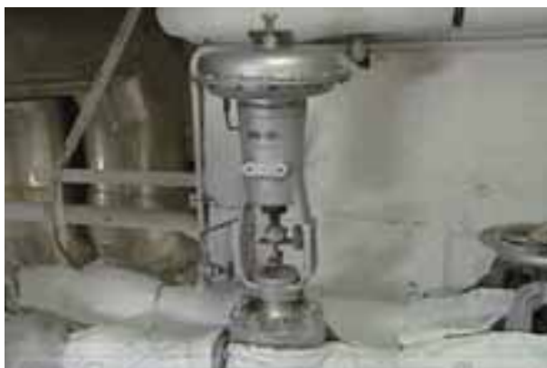
図 97 ダイヤフラム板破損
