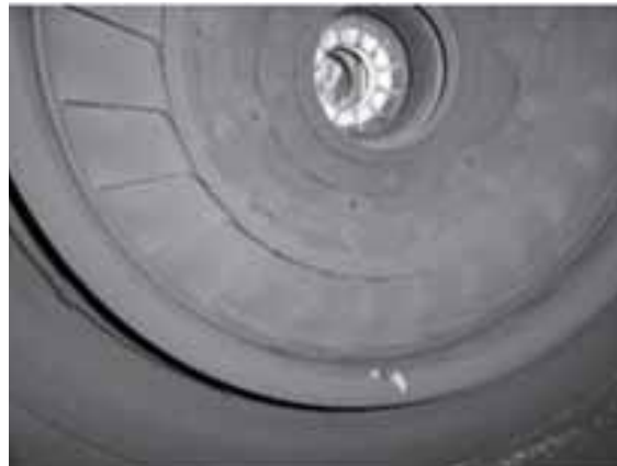
図 21 炭素付着で汚損されたノズルリング 参考文献 *7
