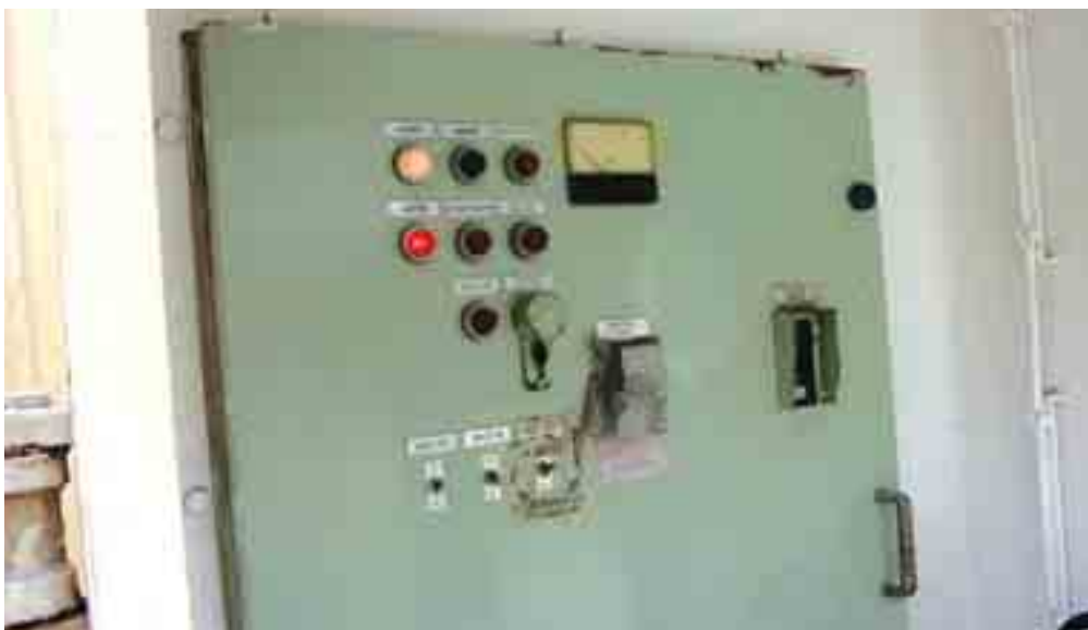
写真4 運転台のコントロールパネル
