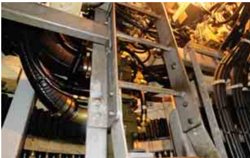
写真3 クレーン架構内の機器と油圧システム
