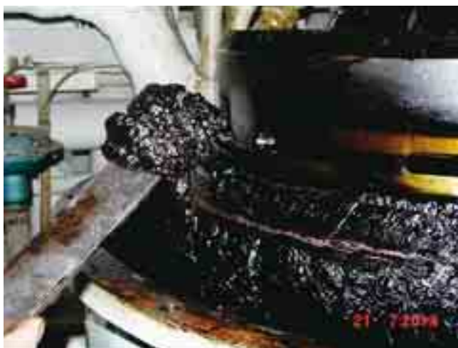
清浄機内部のボウル - 燃料の不安定性によるスラッジ堆積 Purifier Bowl - Sludge due to poor fuel stability
