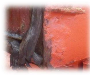
ハッチカバー用ガスケット の整備不良
