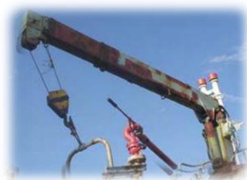
吊り上げ装置類の SWL マーキング不明瞭
