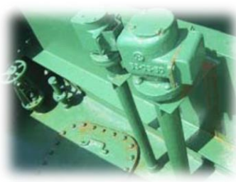
エアイベントパイプの 識別表示がない
